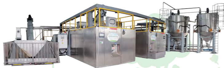
中型有机垃圾集中处理站
